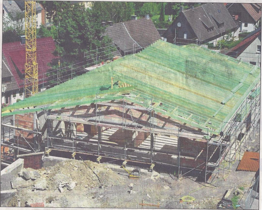
Das neue Gemeindehaus der Kreuzkirche wächst sichtlich, inzwischen wird bereits am Dachstuhl gearbeitet, was der Blick aus der Vogelperspektive deutlich zeigt.
