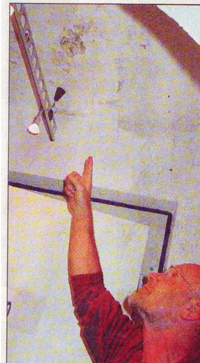
Hans-Georg Ahl zeigt Schäden im Keller – Regenwasser läuft durch den ganzen Turm.
